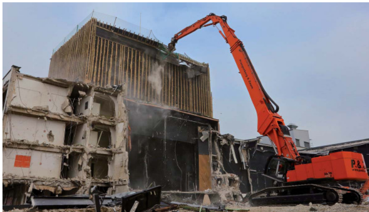
Abriss Theater: Bei hohen Gebäuden haben herkömmliche Bagger ausgedient! Niegelneue und nur mit speziell geschultem Personal bedienbar - hier der größte Longfront-Bagger Deutschlands mit einer Auslage von 52 Metern und einem Gewicht von 155 Tonnen bei seinem ersten Einsatz.
